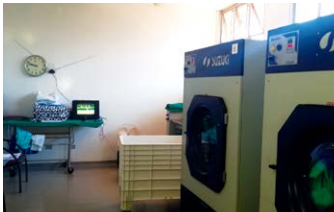
Lavanderia não tinha ventilação e estrutura adequadas
