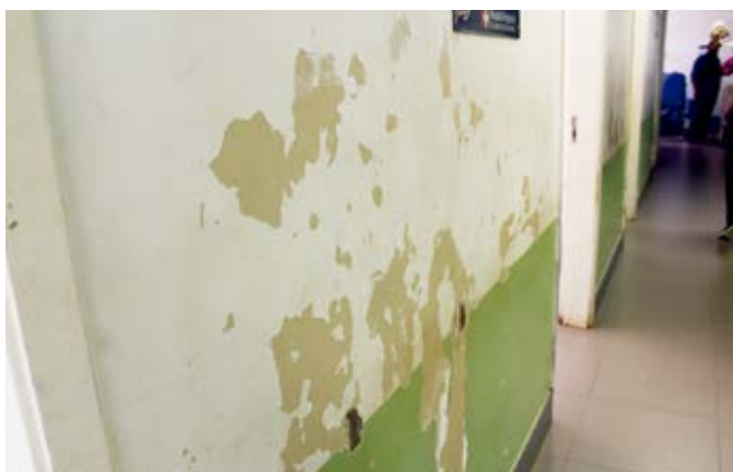
Antes da reforma, as paredes eram sujas, descascadas, com infiltrações e rachaduras
